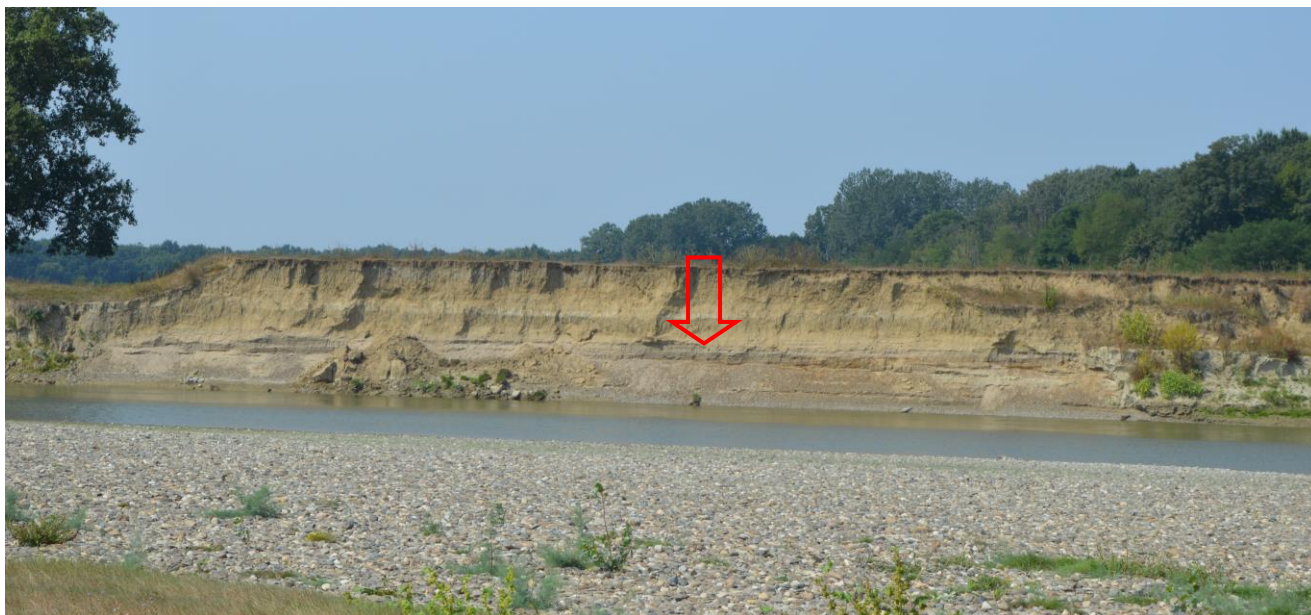
Perimetrul de exploatare Ion Creangă 2 – se poate observa lipsa copertei de sol
