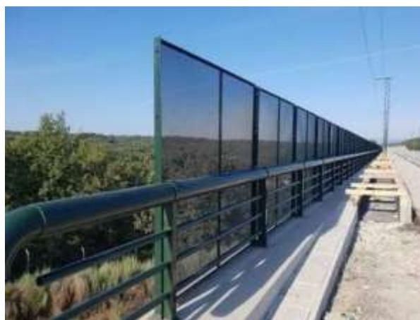
Figura nr. 5-2 Exemplu de panouri anticoliziune (atenție, panourile din exemplu nu au înălțimea de 3m)
