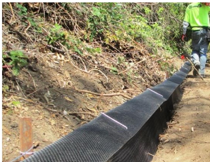
Figura nr. 5-21 Exemplu al unui gard permanent pentru amfibieni și reptile (Sursa: ERTEC Environmental Systems)
