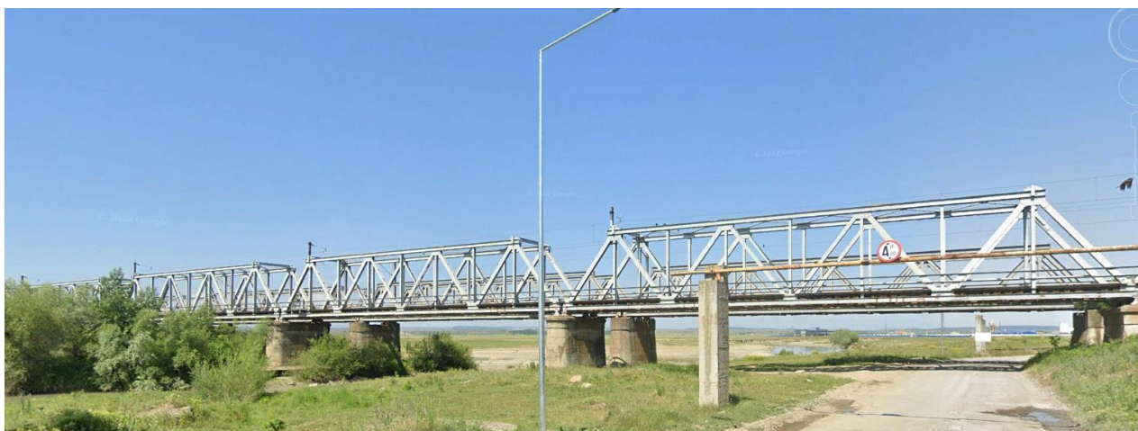
Figura - Pod km.343+714, linia de cale ferată Ploiești – Vicșani – zona culeei Roman
