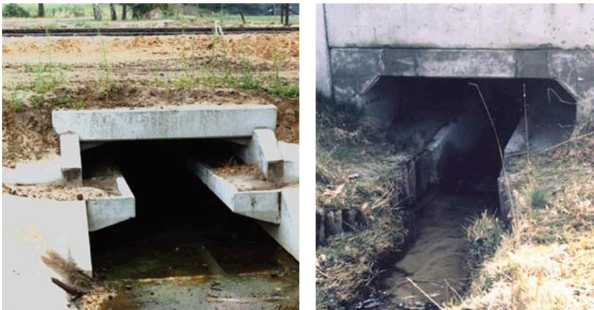
Figura nr. 5-25 Exemple ale unor subtraversări pentru specii de faună de dimensiuni mici, similare celor propuse ca măsură pentru menținerea conectivității
