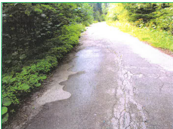
Km 12+873 – Alunecare veche stabilizată de arborii din aval
