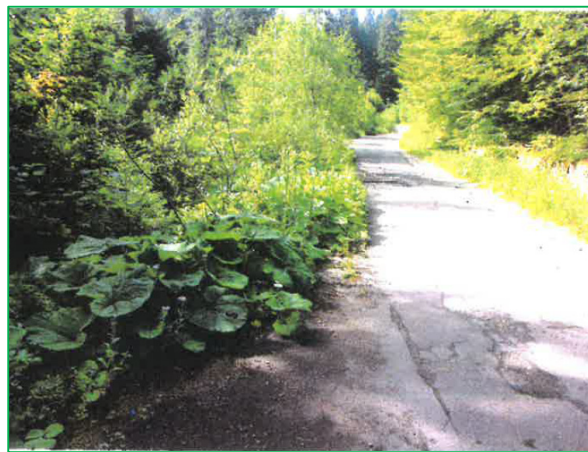
Km 13+024 – Alunecare veche stabilizată de arborii din aval
