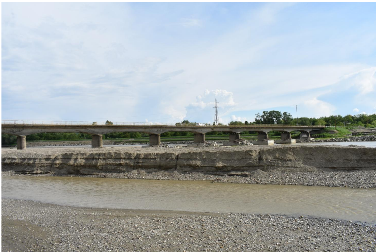
Acumularea de aluviuni din perimetrul Tupilați amonte pod
