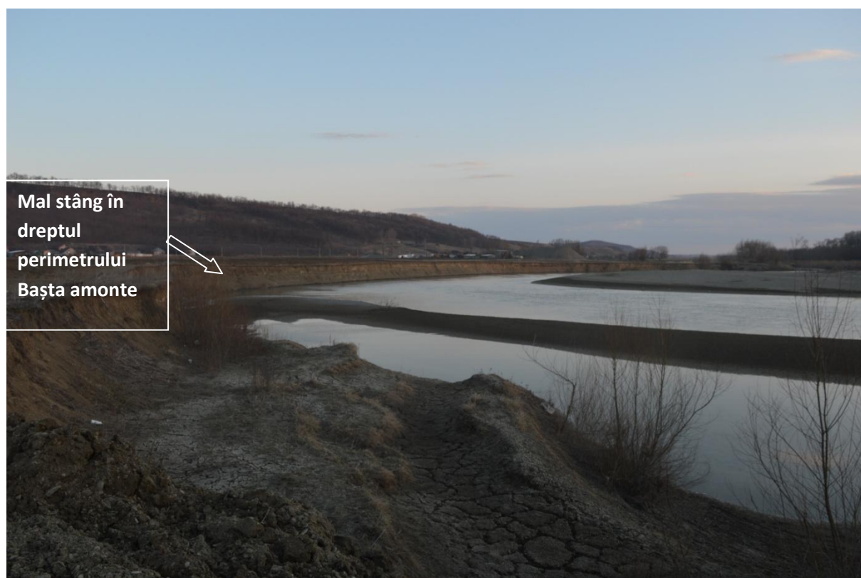
Eroziune mal stâng în dreptul perimetrului Bașta amonte
