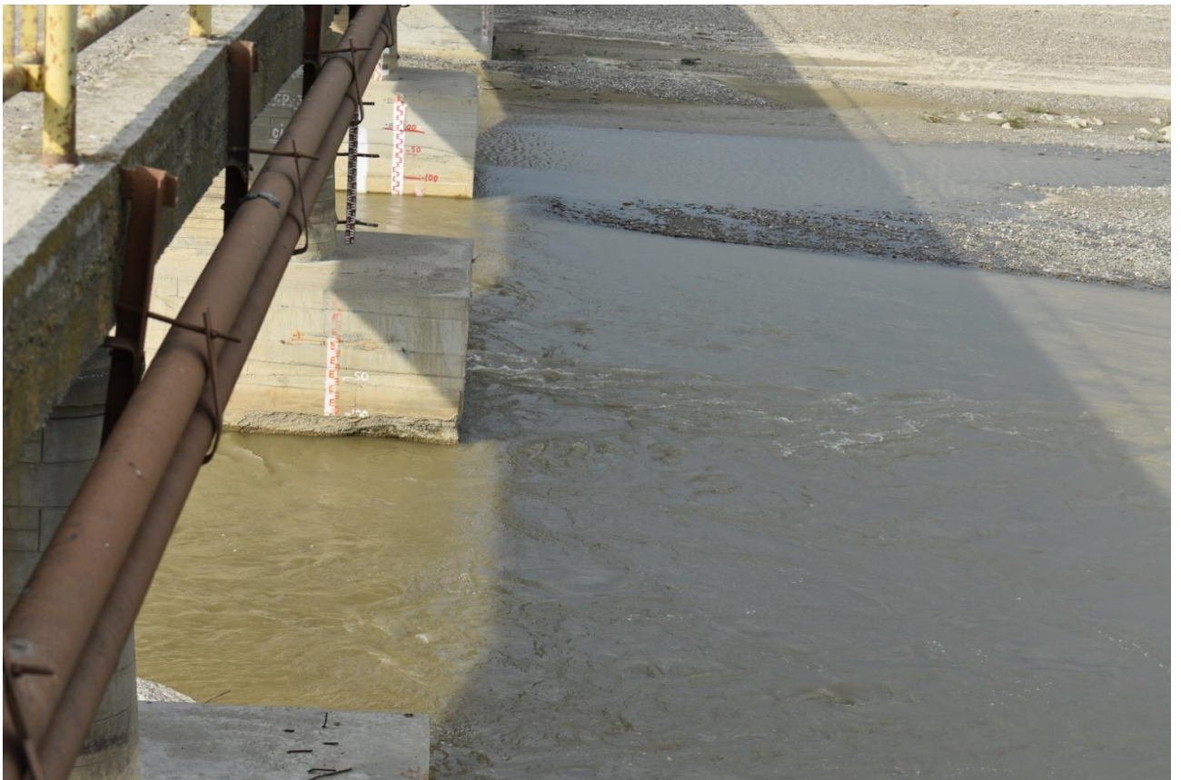
Fenomen erozional al pilonilor de susținere a podului rutier
