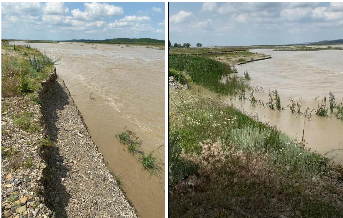
Evidențierea eroziunii malului drept al râului, în zona perimetrului propus
